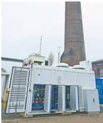
Neue und alte Technologie: der Elektrolyseur vor dem denkmalgeschützten Schornstein des Mainova-Heizwerkes in der Frankfurter Schielestraße
