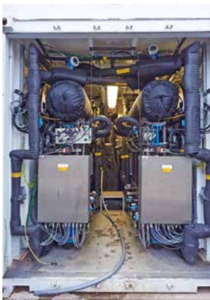
Hier entsteht der Wasserstoff aus nichts als Wasser und Strom: Die Innenansicht des Elektrolyseurs zeigt die isolierte wasserstoff- und sauerstoffführende Verrohrung und Vorratsbehälter.
